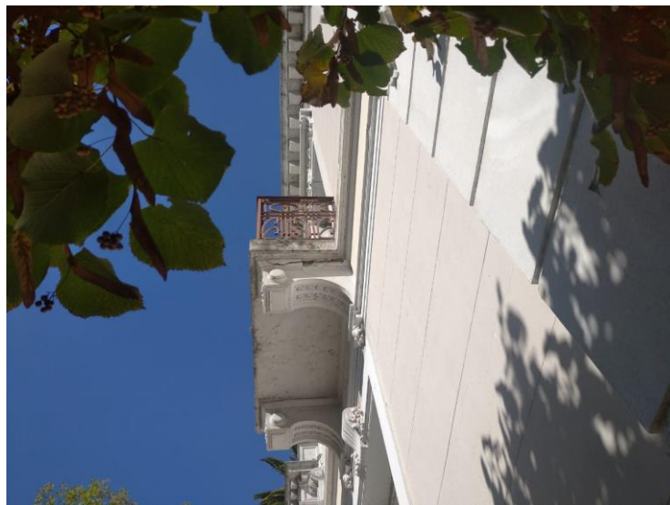
Fisura en el balcón sobre Santa Fe
