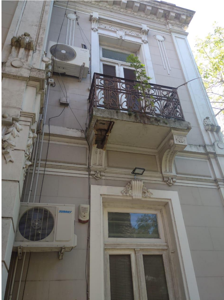
Rotura de una de las ménsulas del balcón 1.º piso.
