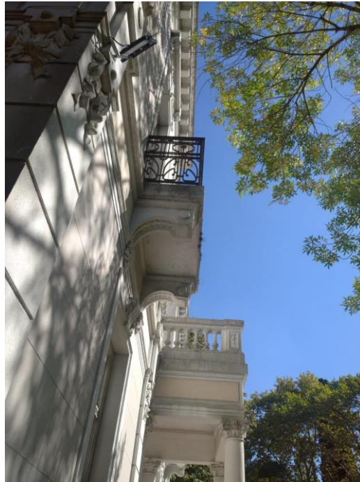
Moho en balcones
