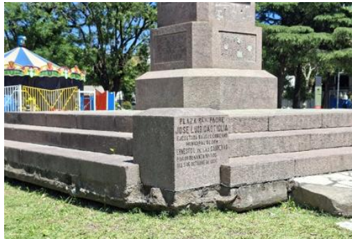
Detalle del pedestal, donde se observa la pérdida de relleno de tierra en su base.
