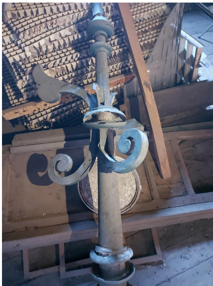
Un pináculo de zinc desprendido de la cubierta y resguardado dentro del edificio (Foto M. Fugardo, 2022).
